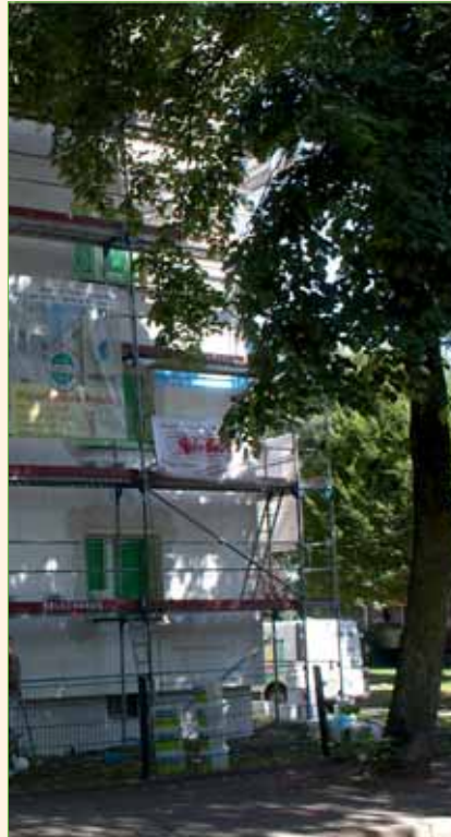
In der Harthorststraße stehen die Bäume viel zu dicht an den Häusern.
